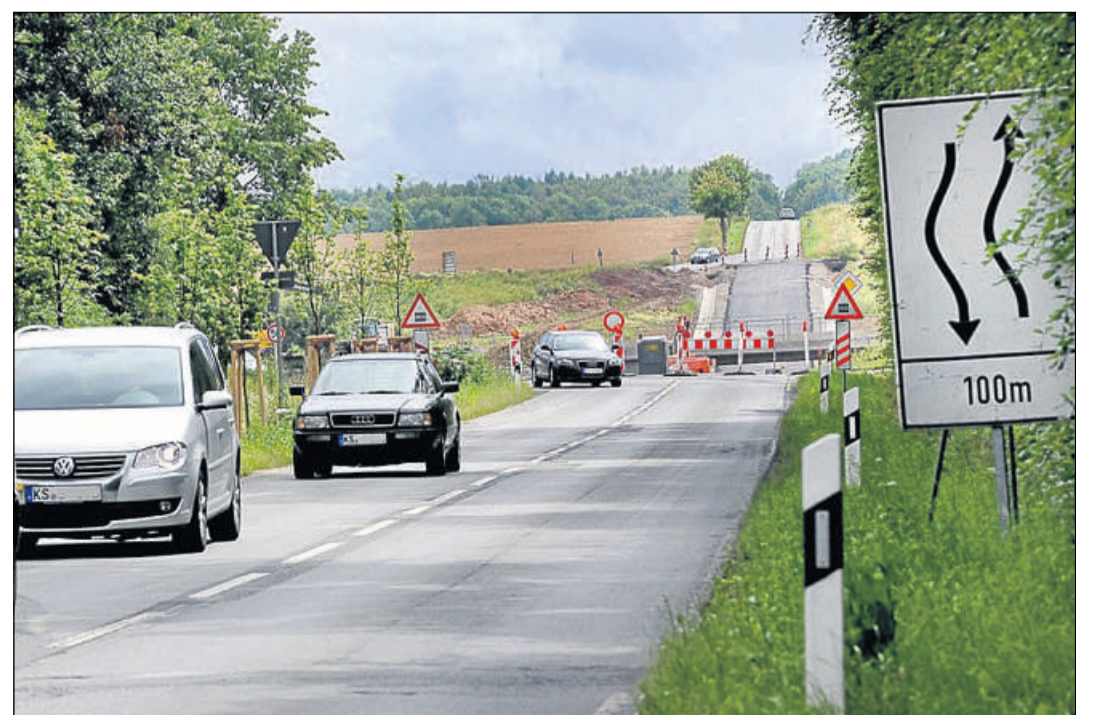
Baustelle: In die Endphase gehen die Bauarbeiten an der neuen Unterführung der Bahnstrecke bei Ahnatal. Unser Bild zeigt den Blick vom Kreisel Heckershausen in Richtung Kassel.
